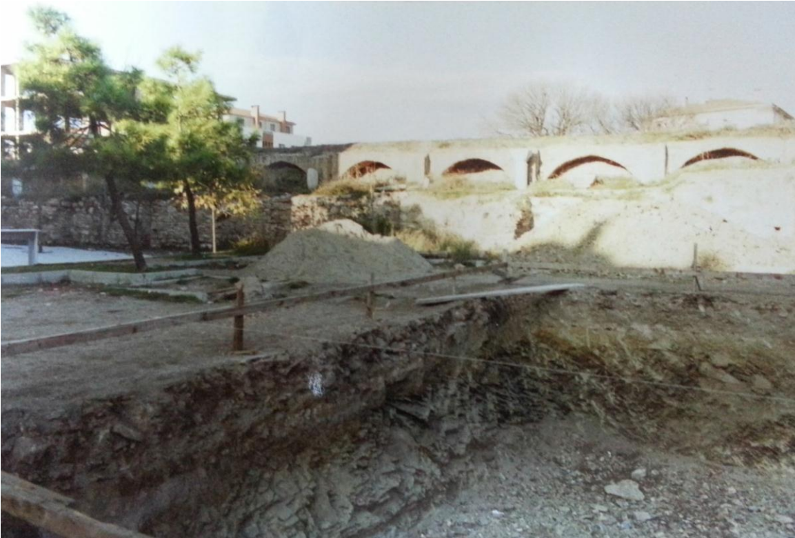
Fotoğraf 28: Mevcut çocuk parkı alanında yapılan izinsiz temel kazısı - 1997 (Koruma Kurulu Arşivi)
